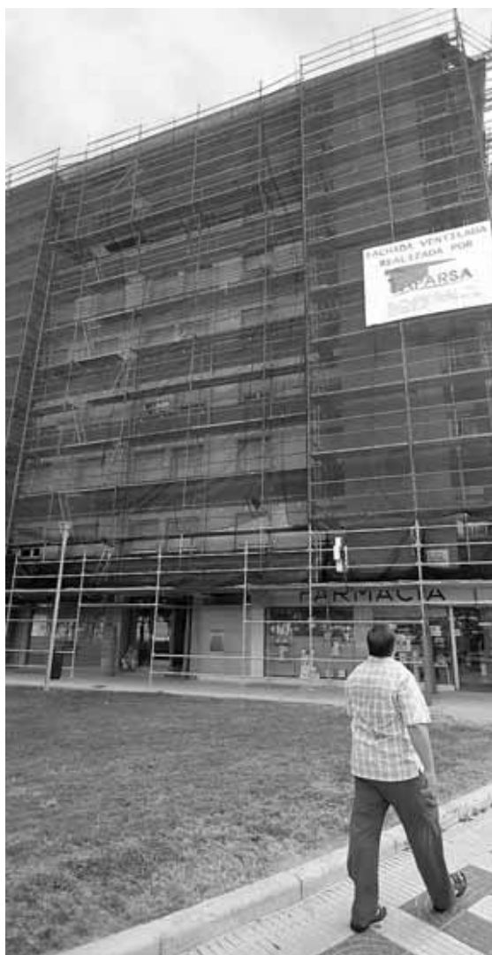
Obras de rehabilitación en la fachada de un edificio. FOTO: UNAI BEROIZ
