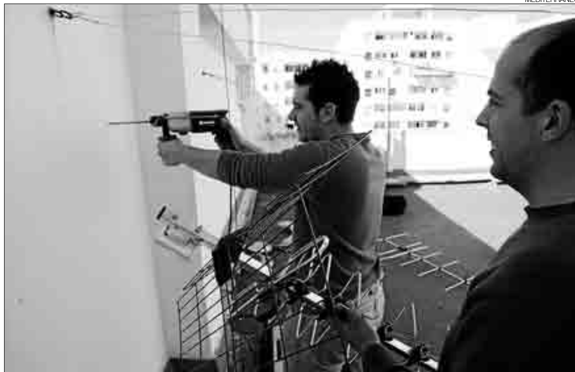
►► Caos ► Servicios como la instalación de antenas o TDT implican derramas extraordinarias.
