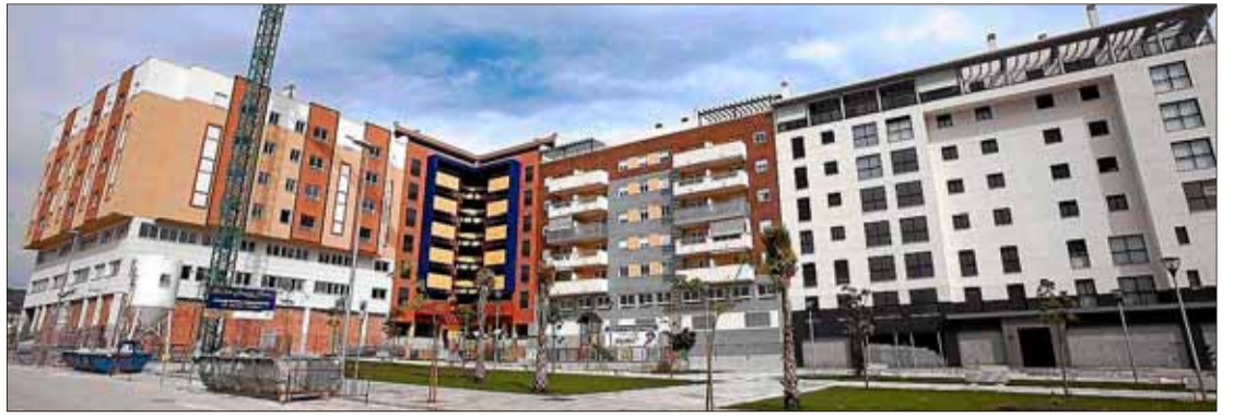
Edificios de viviendas en construcción en las afueras de la capital. / EL MUNDO
